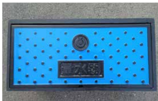
水道メーターボックス
