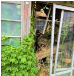
(崩落寸前の空き家)
